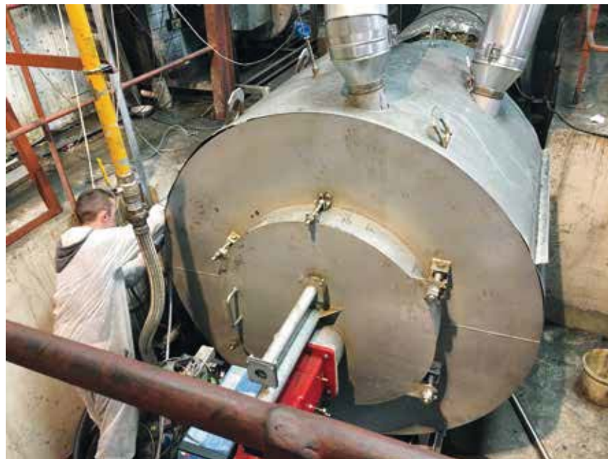
Рис. 3. Вихревая камера сгорания ВУТ установлена непосредственно перед печью Заказчика
